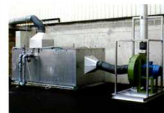
Unité Sorbicat : sur site industriel (cabine de peinture)
